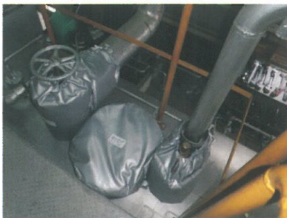
ボイラー上部バルブ、蓋用
